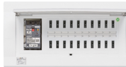
ニューコスモシリーズ パネルS (主幹漏電ブレーカ 取替後)
