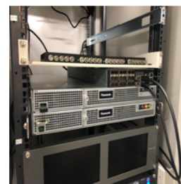
Kairos(データセンター内)
