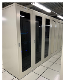
データセンター
