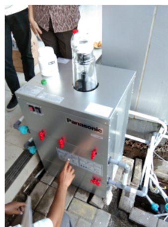
【セントラル水浄化機器（設置）】
