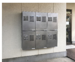
【アパートに設置された宅配ボックス】
