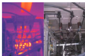
変電設備等の発熱異常検知
