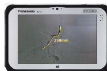
ひび割れの計測例
