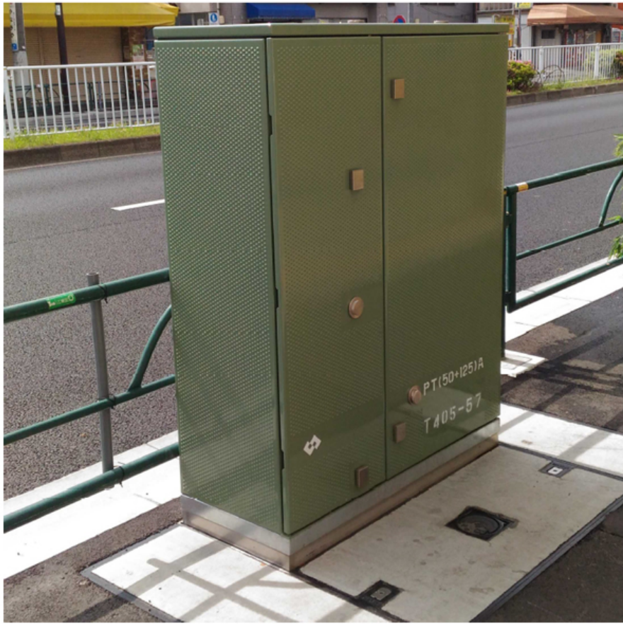
配電地上機器
