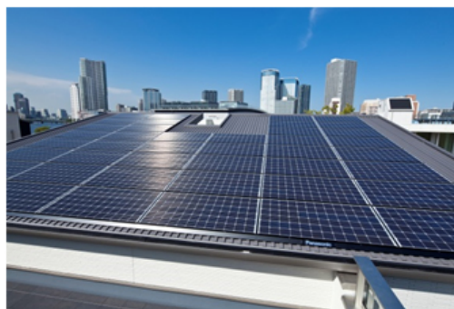
ルーフガーデンから見た太陽光パネル(3階)
